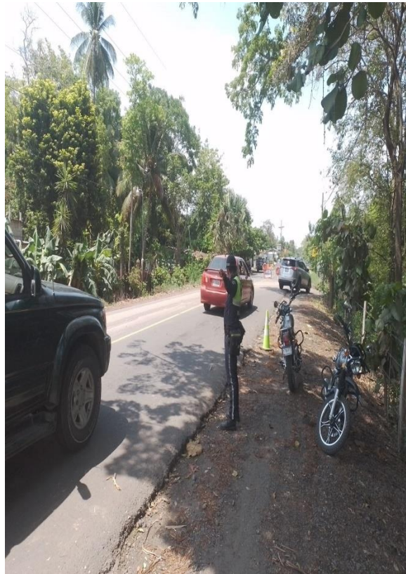
REGULACIÓN DE TRAFICO EN CENTRO DOS
