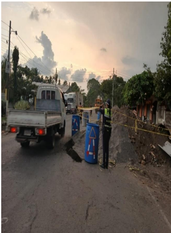
SEÑALIZACIÓN EN CALLE PANAMA
