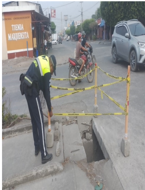
SEÑALIZACION DE REJILLA EN CALLE HONDURAS
